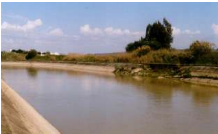
Rotura del Canal del Bajo Guadalquivir en la zona donde confluye con el arroyo Fuentes
