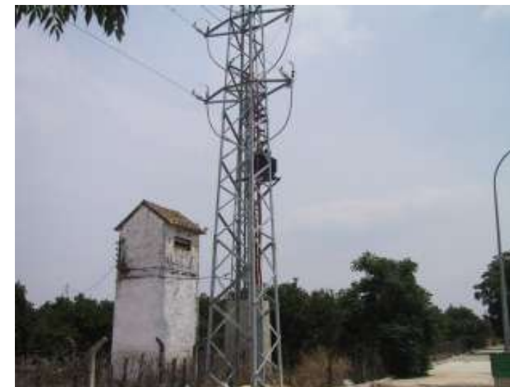
Apoyo de bajada a subterráneo línea M.T. Palma-1
