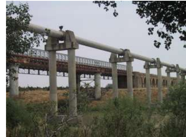
Puente acceso norte. Paso de tuberías de abastecimiento
