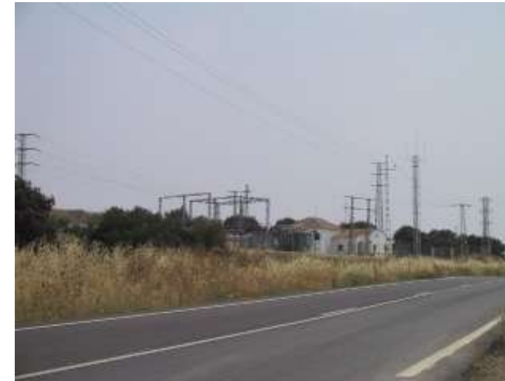
Subestación eléctrica en carretera comarcal CO-140
