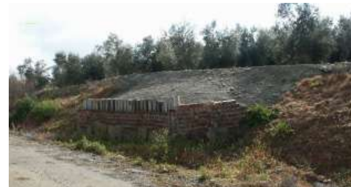
Pérdida de estabilidad por apertura de camino
