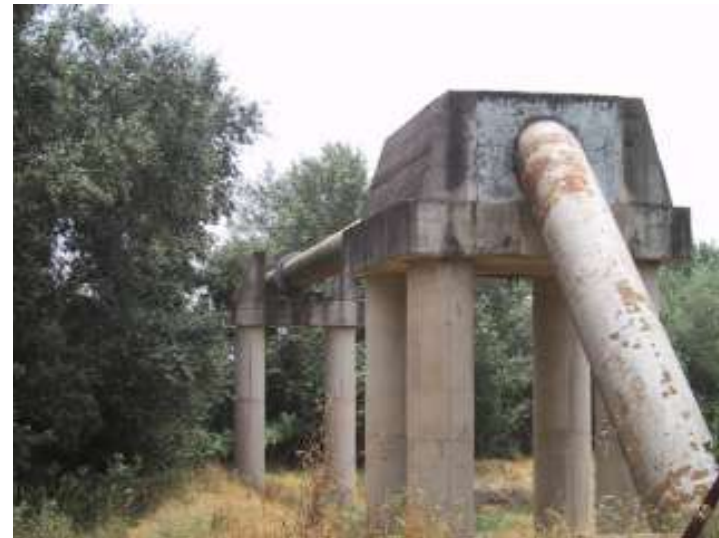
Paso de tuberías de abastecimiento
