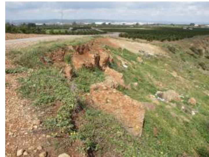
Deslizamiento en la margen del río Genil
